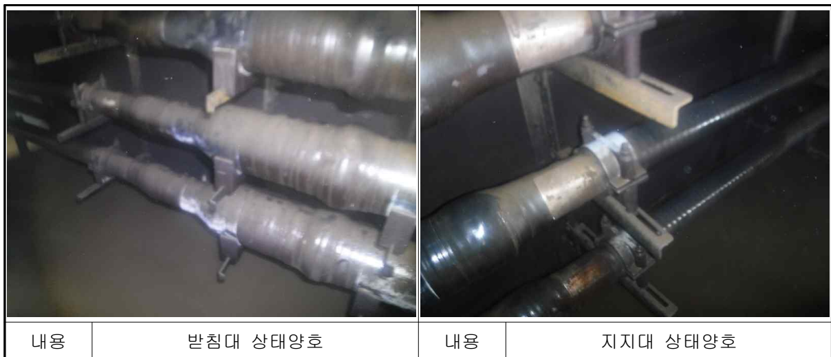
【사진 6.8】 부속 및 부대설비 현황
