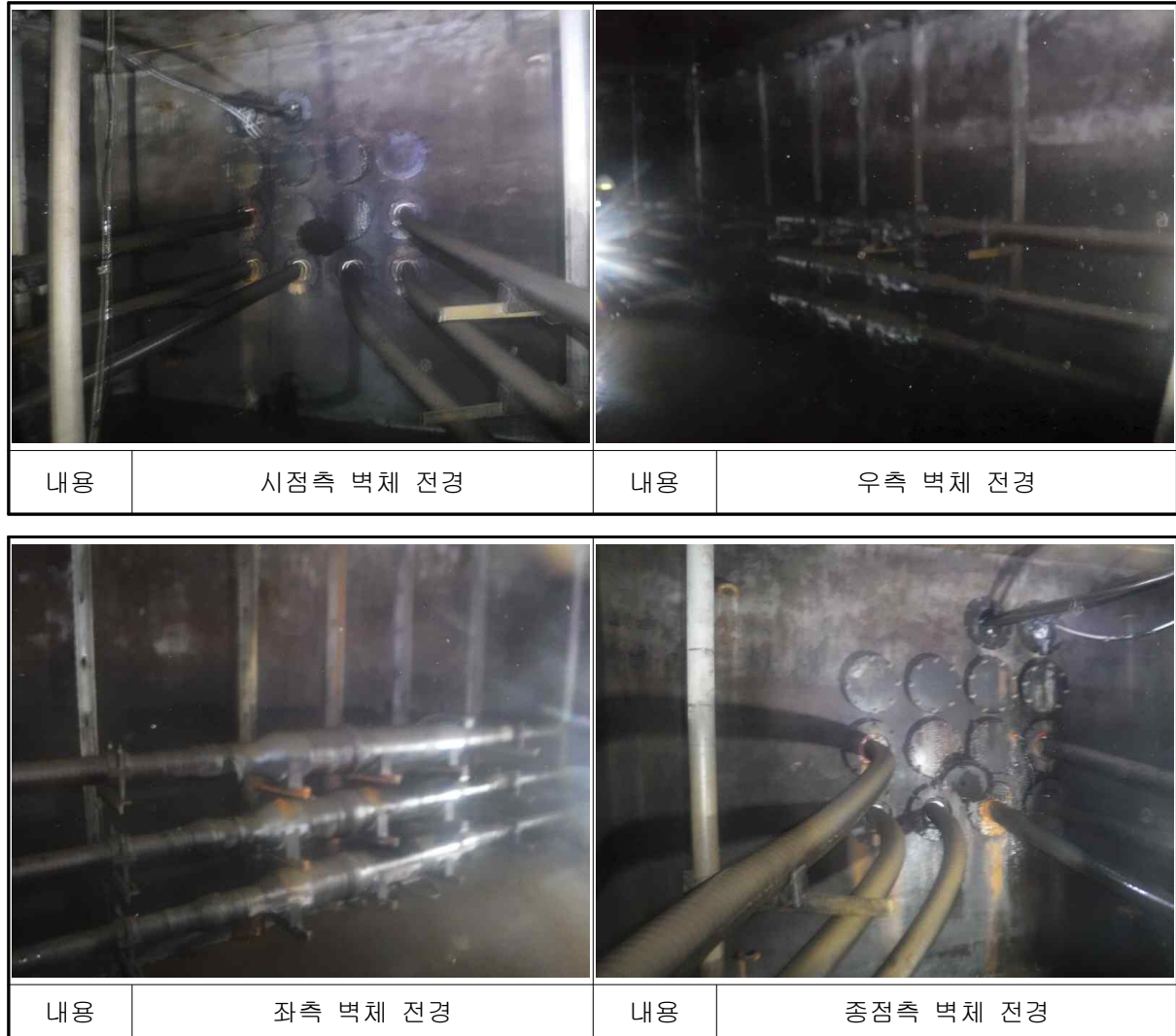
[사진 6.5] 문산~선유#2 전경
