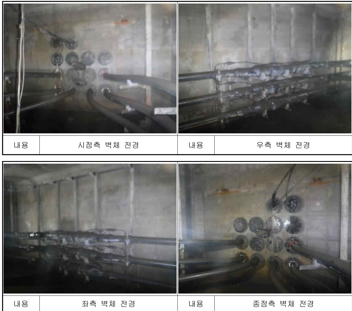
[사진 6.13] 문산~선유#4 전경
