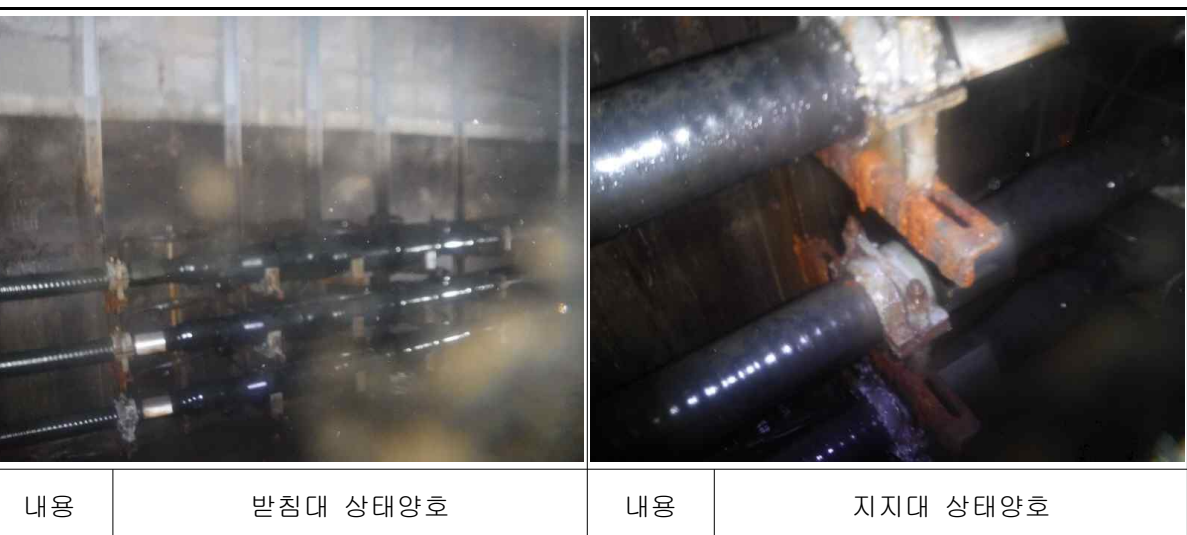
【사진 6.4】 부속 및 부대설비 현황
